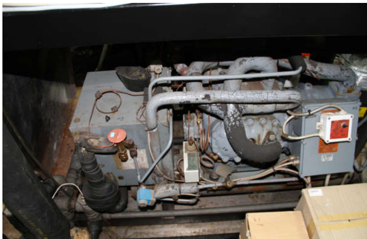
ภาพที่ 31 compressor
